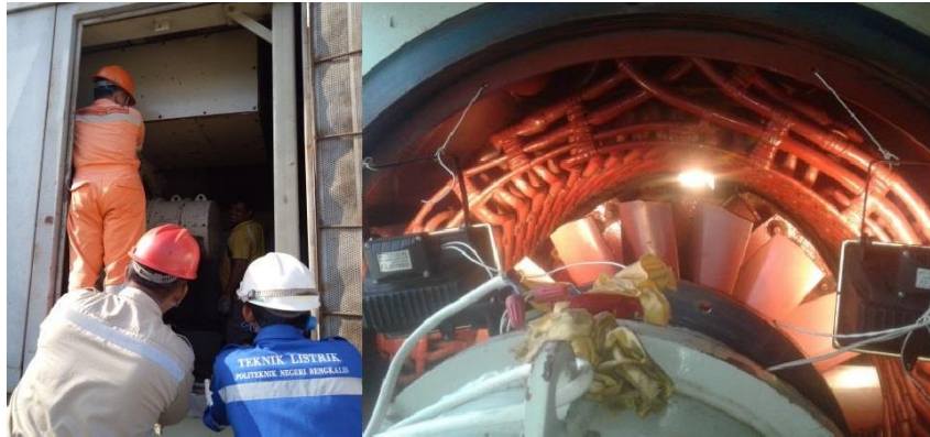
Gambar 10 pemeliharaan generator turbin
