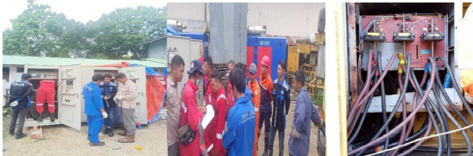
Gambar 9 tes kemampuan genset menggunakan load bank
