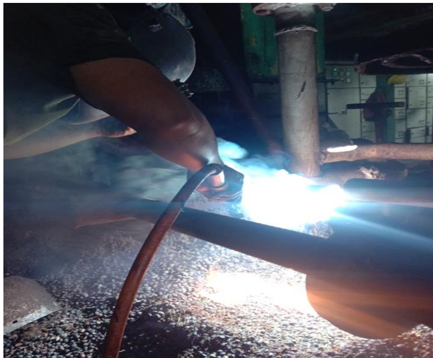
Gambar 3. 4 perbaikan pipa setam
