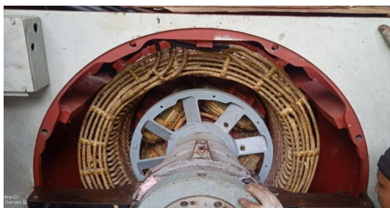
Gambar 3.4 Stator generator (Sumber : Dokumentasi)
