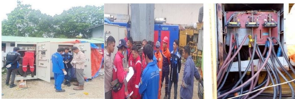
Gambar 2.4 Tes kemampuan genset menggunakan load bank (Sumber : Dokumentasi)
