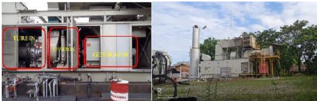
Gambar 3.1 Generator (Sumber : Dokumentasi)
