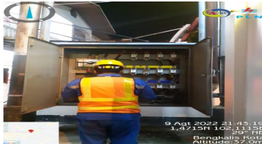
Gambar 2.45 Pemadaman bergilir (Sumber: PT. Adra Gemilang 2022)
