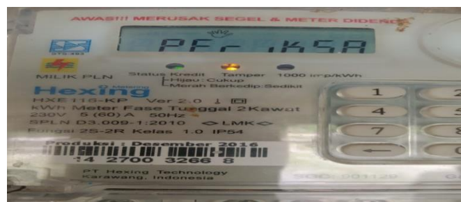
Gambar 2.54 Mengatasi kWh periksa di rumah pelanggan (Sumber: PT. Adra Gemilang 2022)
