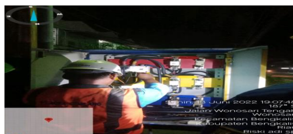
Gambar 2.8 Penyeimbangan beban trafo
