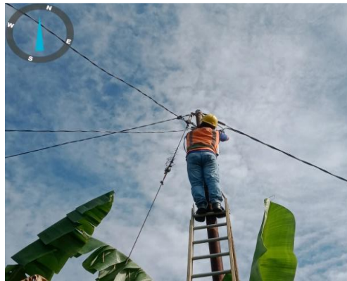
Gambar 2.31 Mengatasi gangguan lost kontak nol/netral. (Sumber: PT. Adra Gemilang 2022)
