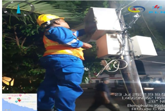
Gambar 2.33 Mengganti MCB pelanggan life time (Sumber: PT. Adra Gemilang 2020)
