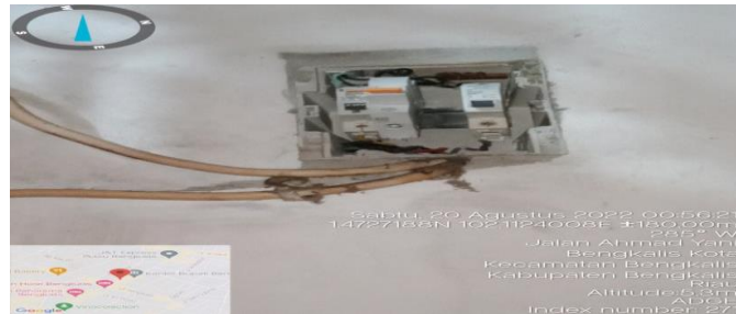
Gambar 2.53 Menganti mcb milik pelanggan yang terbakar (Sumber: PT. Adra Gemilang 2022)
