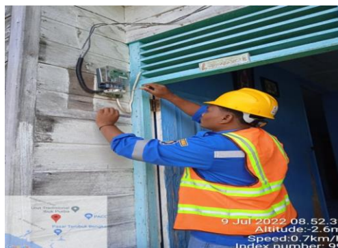
Gambar 2.24 Menganti MCB (Miniature Circuit Breaker) pelanggan
