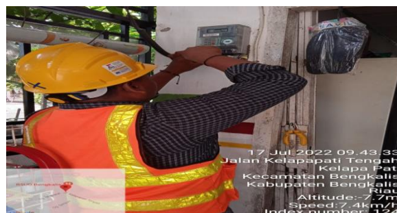
Gambar 2.30 Menganti MCB (Miniature Circuit Breaker) pelanggan (Sumber: PT. Adra Gemilang 2022)
