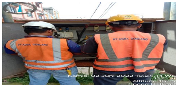
Gambar 2.2 Penyeimbangan beban trafo
