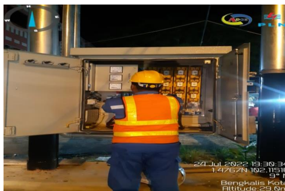
Gambar 2.34 Pemadaman bergilir. (Sumber: PT. Adra Gemilang 2022)
