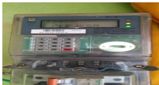
Gambar 2.58 Mengatasi kwh periksa (Sumber: PT. Adra Gemilang 2022)
