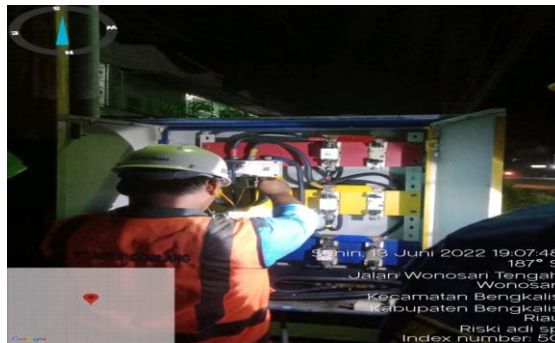
Gambar 2.27 Penyeimbangan beban trafo (Sumber: PT. Adra Gemilang 2022)
