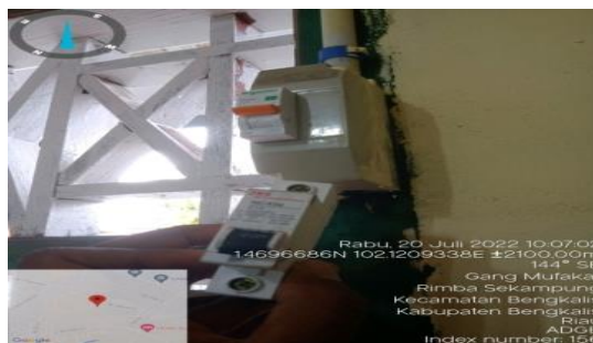
Gambar 2.32 Mengganti MCB di kwh meter di rumah pelanggan. (Sumber: PT. Adra Gemilang 2022)
