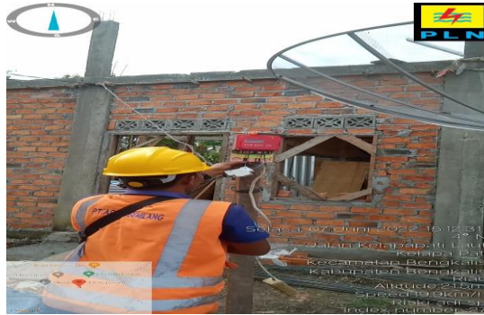
Gambar 2.5 Menganti kWh meter sementara atau dami (Sumber: PT. Adra Gemilang 2022)
