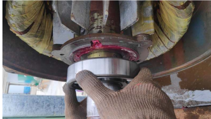
Gambar 2.4 Rechange Bearing Motor 75KW (Sumber: dokumentasi PT. Sari Dumai Oleo)
