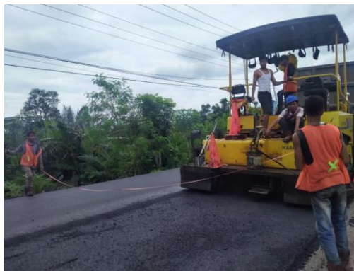
Gambar 4.20 Pengecekan Lebar Laston Lapis Aus (AC-WC NR ) (Sumber: Dokumentasi Lapangan Kerja Praktek 2022)
