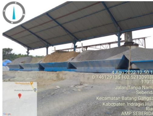
Gambar 4.10 Pemisahan Agregat di Cold Bin (Sumber: Dokumentasi Lapangan Kerja Praktek 2022)
