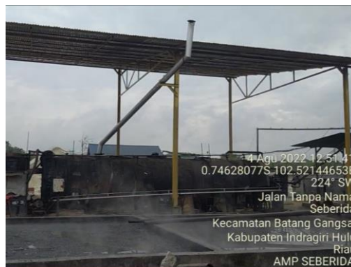
Gambar 4.12 Pemanasan Aspal pada boiler fire tube (Sumber: Dokumentasi Lapangan Kerja Praktek 2022)
