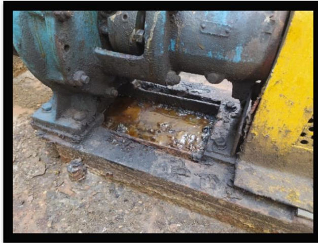
Gambar 4.9 Baseplate Motor Dan Pompa Terkorosi
