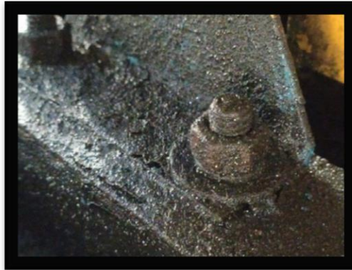
Gambar 4.10 Baut Pengikat Pompa Motor Dan Pompa Terkorosi
