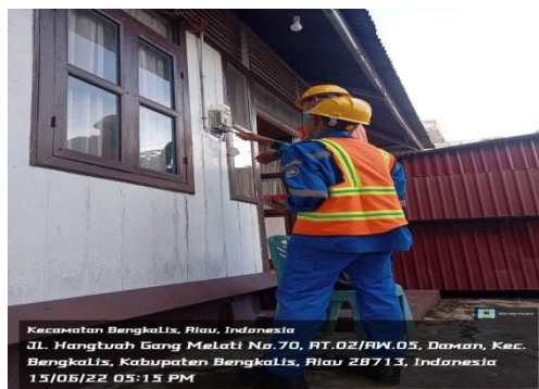
Gambar 2.6 kWh Meter Periksa (Sumber: PT. Adra Gemilang 2022)
