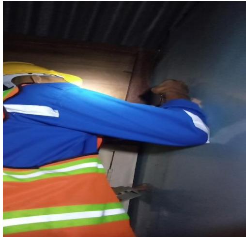
Gambar 2.20 MCB rusak (Sumber: PT. Adra Gemilang 2022)
