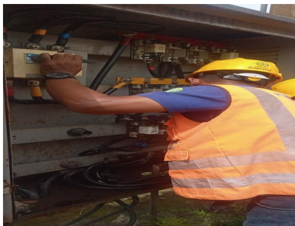
Gambar 2.42 Pemeliharaan PHB-TR (Perangkat Hubung Bagi Tegangan Rendah) (Sumber: PT. Adra Gemilang 2022)
