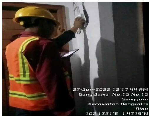
Gambar 2.14 kWh Meter Periksa (Sumber: PT. Adra Gemilang 2022)
