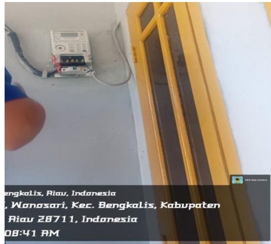
Gambar 2.10 kWh Meter Periksa (Sumber: PT. Adra Gemilang 2022)
