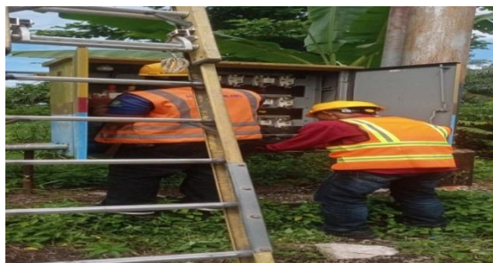
Gambar 2.2 Pemeliharaan PHB-TR (Perangkat Hubung Bagi Tegangan Rendah) (Sumber: PT. Adra Gemilang 2022)
