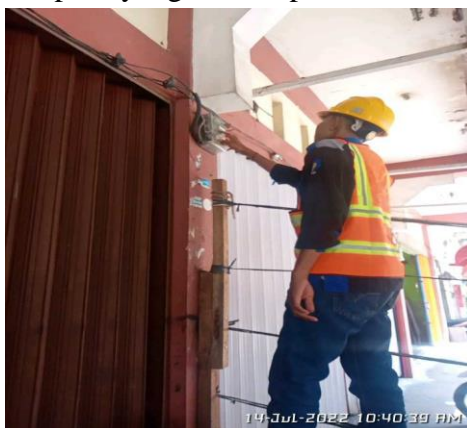
Gambar 2.18 kWh Meter Periksa (Sumber: PT. Adra Gemilang 2022)
