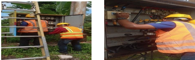
Gambar 2.3 Pemeliharaan PHB-TR (Perangkat Hubung Bagi Tegangan Rendah) (Sumber: PT. Adra Gemilang 2022)
