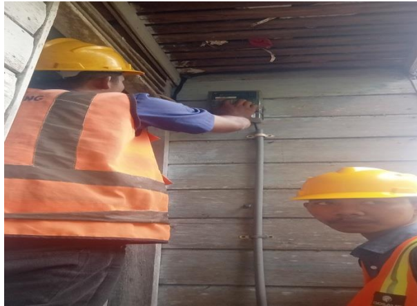
Gambar 2.34 kWh Meter Periksa (Sumber: PT. Adra Gemilang 2022)
