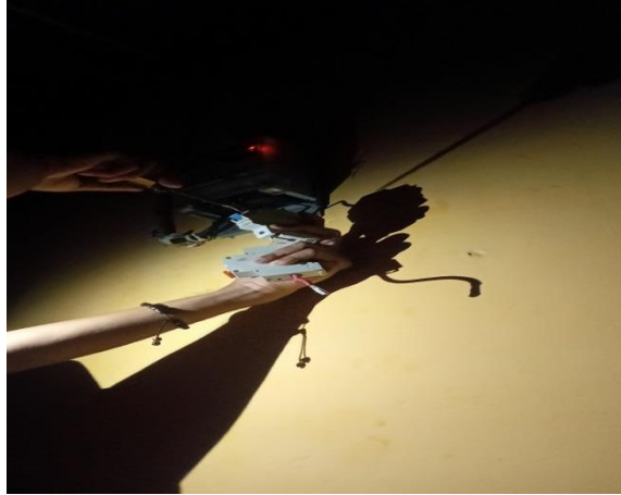
Gambar 2.41 MCB rusak (Sumber: PT. Adra Gemilang 2022)
