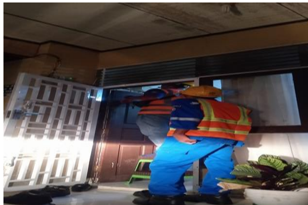
Gambar 2.3 kWh Meter Periksa (Sumber: PT. Adra Gemilang 2022)
