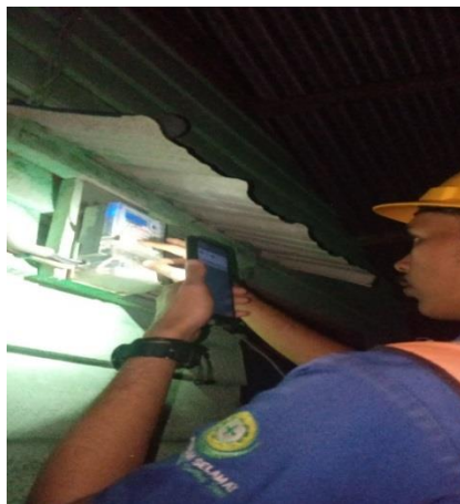
Gambar 2.21 kWh Meter Periksa (Sumber: PT. Adra Gemilang 2022)
