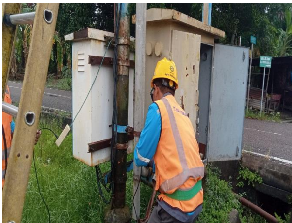
Gambar 2.25 Kabel putus (Sumber: PT. Adra Gemilang 2022)
