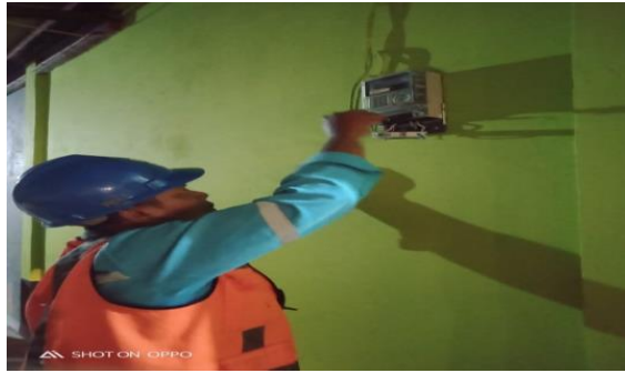
Gambar 2.4 MCB rusak (Sumber: PT. Adra Gemilang 2022)
