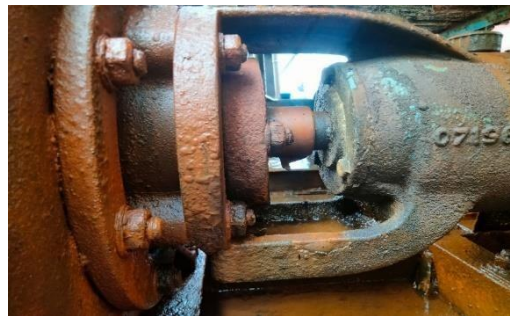
Gambar 4.8 Korosi Pada Bagian Pompa Pentransfer Air 8
