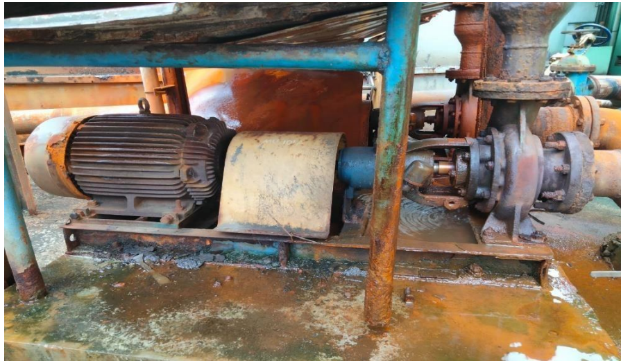
Gambar 4. 1 Pompa Sentrifugal Pentransfer Air di Area Tank Air 101
