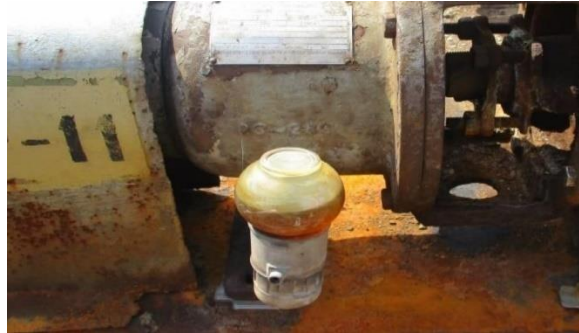
Gambar 4.9 Pendingin oli pompa pentransfer air
