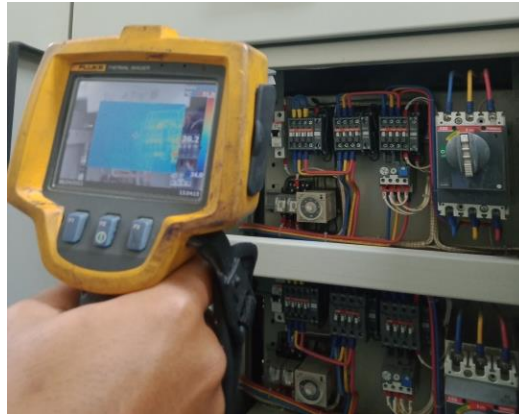
Gambar 2.6 : Pengecekan Panel Menggunakan IR Check.
