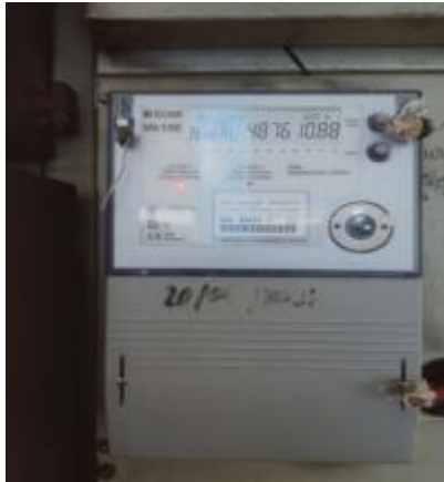
Gambar 2.37 Kegiatan monitoring KWH setiap jamnya (Sumber: PT. Megapower Makmur Tbk. 2022)
