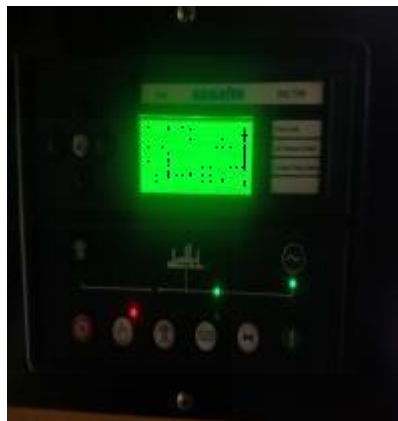
Gambar 2.40 Kegiatan monitoring KWH setiap jamnya (Sumber: PT. Megapower Makmur Tbk. 2022)
