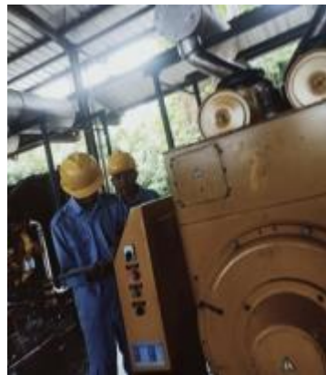
Gambar 2.3 Kegiatan monitoring KWH setiap jamnya (Sumber: PT. Megapower Makmur Tbk. 2022)
