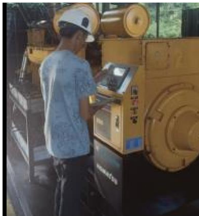
Gambar 2.17 Kegiatan monitoring KWH setiap jamnya (Sumber: PT. Megapower Makmur Tbk. 2022)
