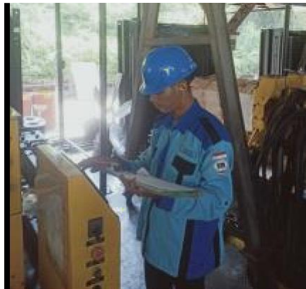
Gambar 2.25 Kegiatan monitoring KWH setiap jamnya (Sumber: PT. Megapower Makmur Tbk. 2022)
