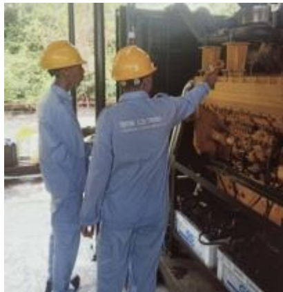
Gambar 2.15 Kegiatan monitoring KWH setiap jamnya (Sumber: PT. Megapower Makmur Tbk. 2022)
