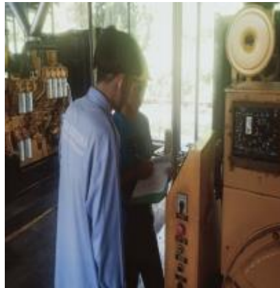
Gambar 2.13 Kegiatan monitoring KWH setiap jamnya (Sumber: PT. Megapower Makmur Tbk. 2022)
