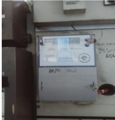
Gambar 2.36 Kegiatan monitoring KWH setiap jamnya (Sumber: PT. Megapower Makmur Tbk. 2022)
