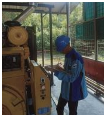
Gambar 2.5 Kegiatan monitoring KWH setiap jamnya (Sumber: PT. Megapower Makmur Tbk. 2022)
