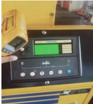
Gambar 2.39 Kegiatan monitoring KWH setiap jamnya (Sumber: PT. Megapower Makmur Tbk. 2022)
