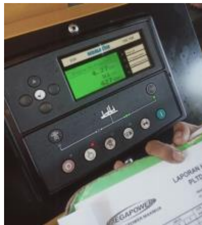
Gambar 2.11 Kegiatan monitoring KWH setiap jamnya (Sumber: PT. Megapower Makmur Tbk. 2022)
