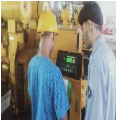
Gambar 2.14 Kegiatan monitoring KWH setiap jamnya (Sumber: PT. Megapower Makmur Tbk. 2022)
