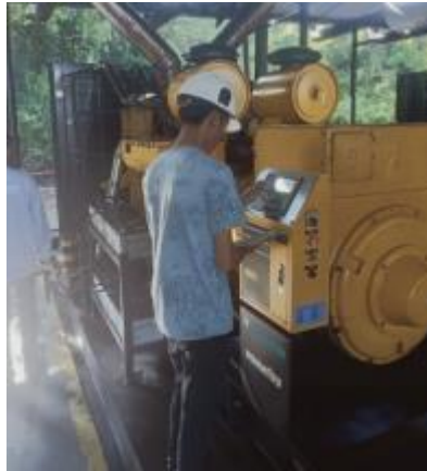
Gambar 2.8 Kegiatan monitoring KWH setiap jamnya (Sumber: PT. Megapower Makmur Tbk. 2022)
