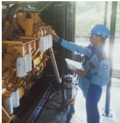
Gambar 2.9 Kegiatan monitoring KWH setiap jamnya (Sumber: PT. Megapower Makmur Tbk. 2022)
