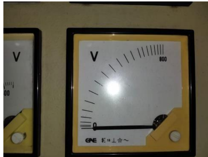
Gambar 3.6 Indikator Voltmeter (Sumber: PT. Megapower Makmur Tbk. 2021)
