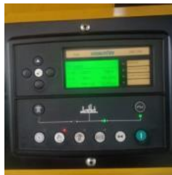
Gambar 2.19 Kegiatan monitoring KWH setiap jamnya (Sumber: PT. Megapower Makmur Tbk. 2022)
