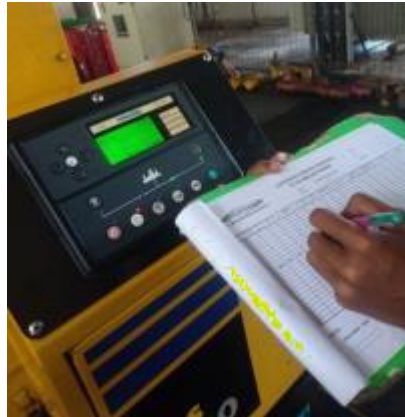
Gambar 2.10 Kegiatan monitoring KWH setiap jamnya (Sumber: PT. Megapower Makmur Tbk. 2022)
