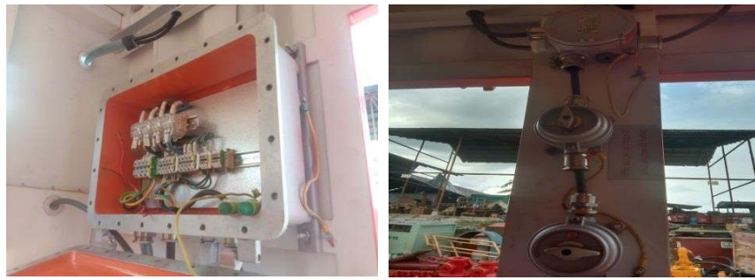
Gambar 2.12: Instalasi listrik lampu sorot. (Sumber: Dokumentasi 2022)
