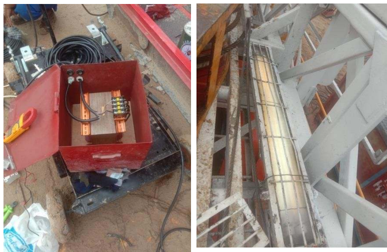
Gambar 2. 13: Memperbaiki dan memasang lampu Fluorencen dimenara Rig dan instalasi listrik di menara Rig . (Sumber: Dokumentasi 2022)
