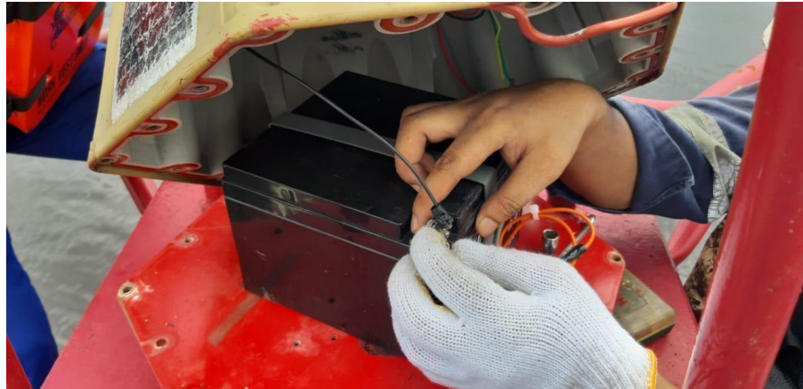
Gambar 3.2.5 proses pengecekan lampu suar dan battery
