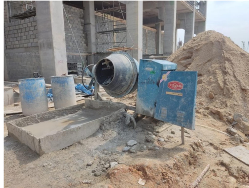
Gambar 3. 38 Molen Mixer Sumber : Dokumentasi lapangan, 2022
