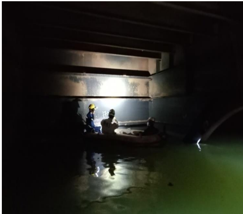
Gambar 3.1 Pemeriksaan ketebalan pelat di tanki (COT)
