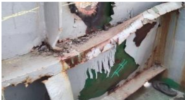
Gambar 2.27 Kerusakan Pada Bulwork
