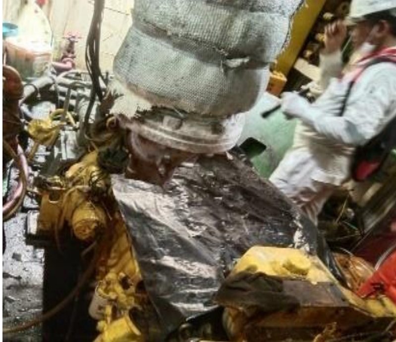
Gambar 2.28 Ruang Kamar Mesin
