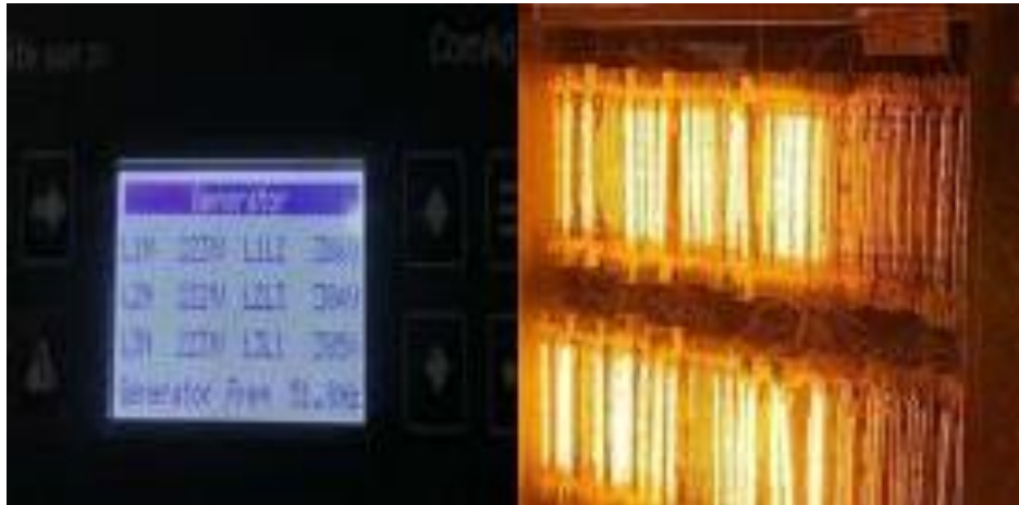
Gambar 2. 90 Pemberian beban pada generator
