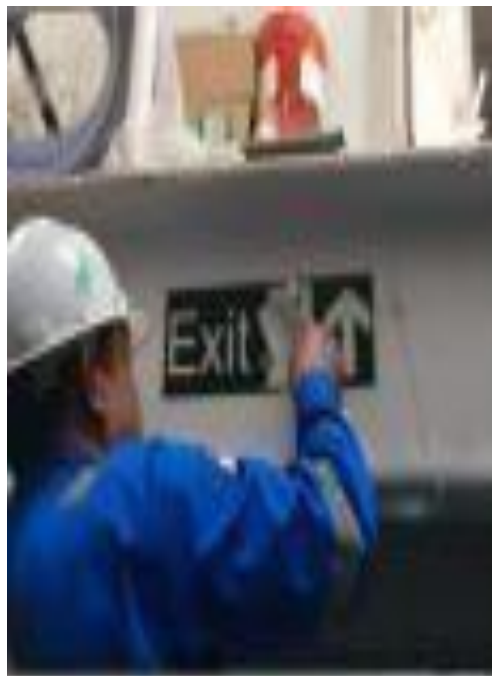
Gambar 2. 82 pemasangan stiker di engine room
