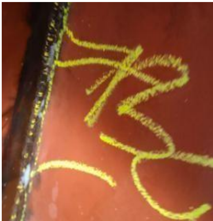
Gambar 2. 74 Kebocoran pada Tangki
