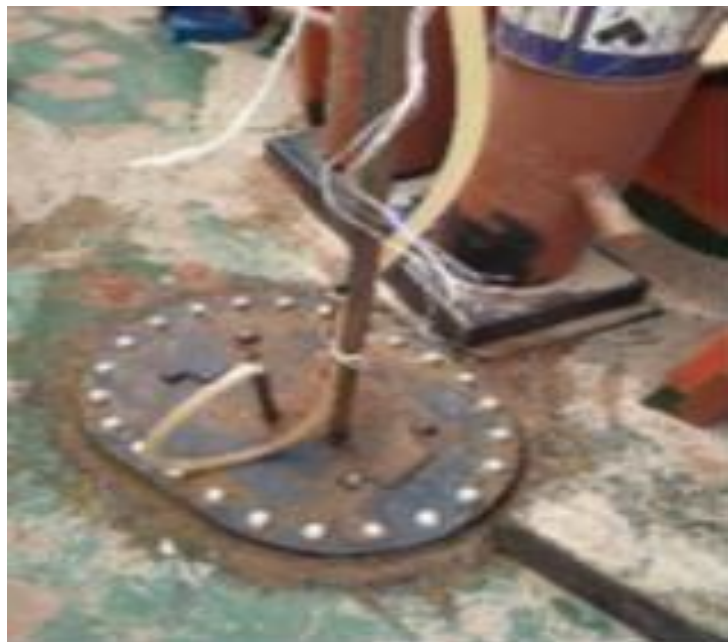
Gambar 2. 73 Selang air pada tutupan mainhole
