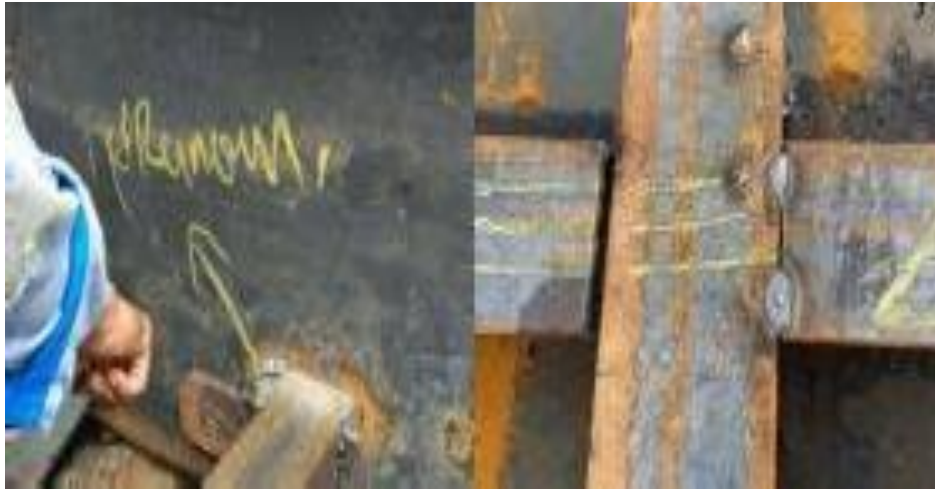
Gambar 2. 101 Pemasangan collar miring dan web frame kurang rata
