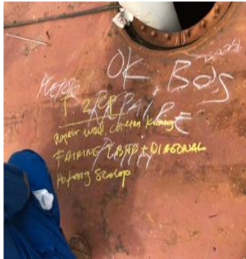
Gambar 2. 37 Hasil visual welding inspect pada void tank
