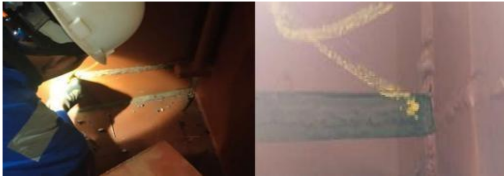
Gambar 2. 11 Hasil Visual Welding dan cacat las Porosity,poor stop/start
