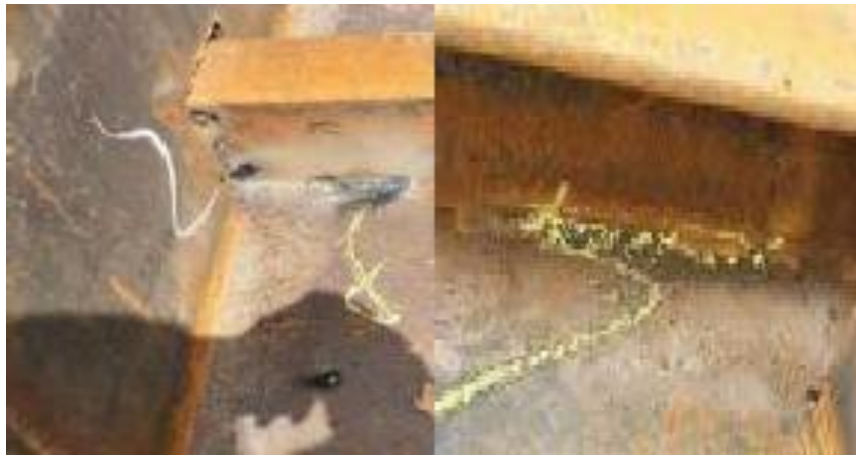
Gambar 2. 66 Proses Visual Welding cacat las undercut dan Stop star
