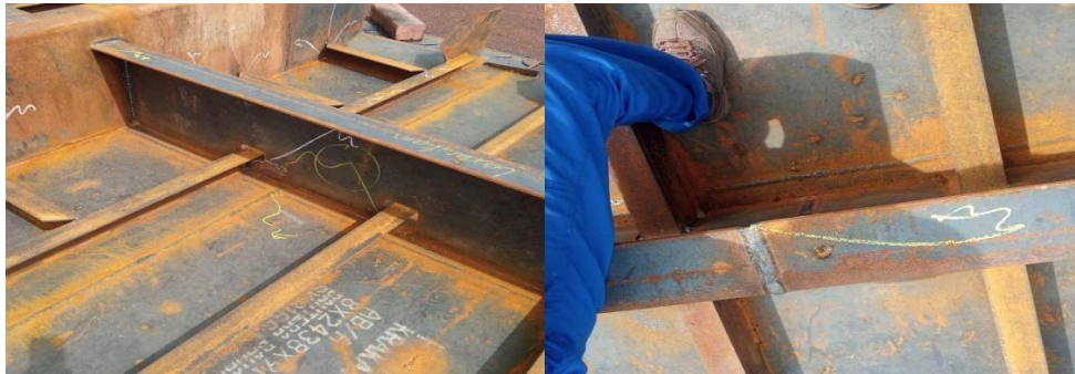
Gambar 2. 7 Hasil Visual Welding dan cacat las Porosity,poor stop/start
