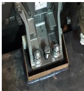
Gambar 3. 3 Pondasi Chockfast pada Dudukan Mesin
