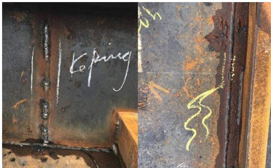
Gambar 2. 35 Hasil Visual Welding dan cacat las Crack,poor stop/start
