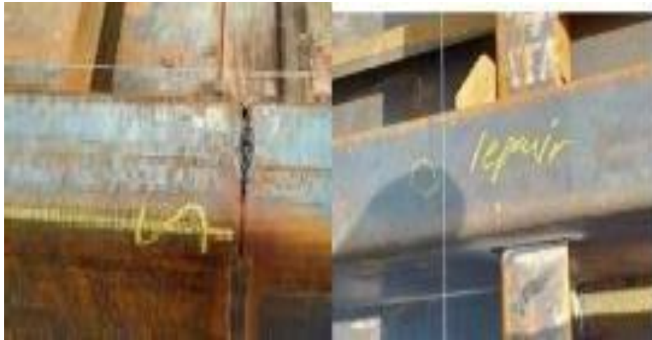
Gambar 2. 99 Fit UP H-619 ketinggian mid kurang harus di repair
