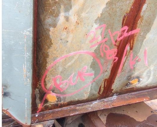
Gambar 3. 9 penandaan lokasi kebocoran
