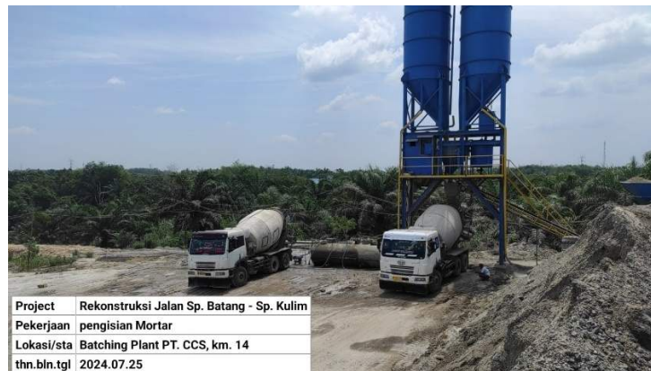
Gambar 3. 6 Produksi Mortar di Batching Plant
