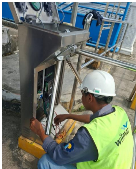
Gambar 3. 7 Pengecekan arus listrik
