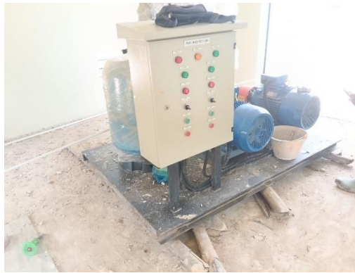
Gambar 3.83 Pompa Siram Rumput Type Centrifugal (Sumber: Dokumentasi Lapangan, 2024)
