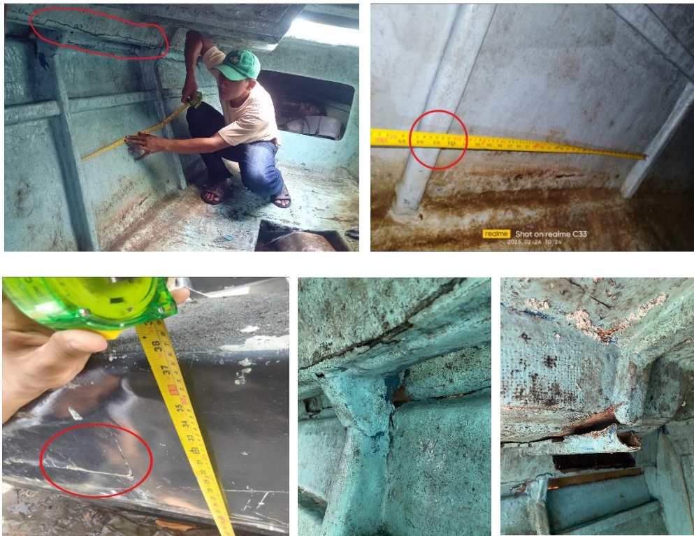
Gambar 1. 3 kerusakan pada konstruksi kapal
