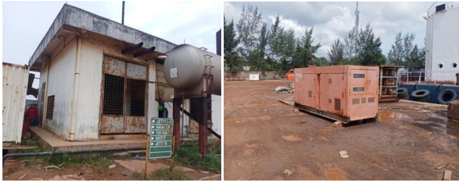
Gambar 1. 7 Generator set dan Listrik PLN Sumber : Penulis
