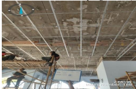
Gambar 3.45 Mengukur panjang kedalaman retakan (Sumber : Dokumentasi lapangan, 2024)
