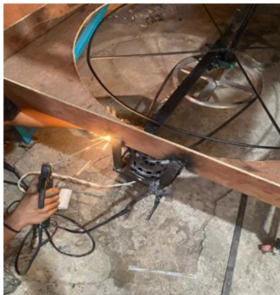
Gambar 4. 10 Instalasi Sistem Pulley serta Kedudukan Motor
