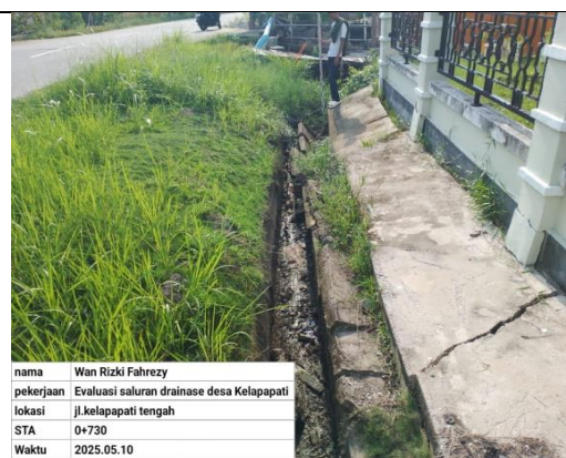
Kerusakan Drainase Di STA 0+750 Sebelah kanan
