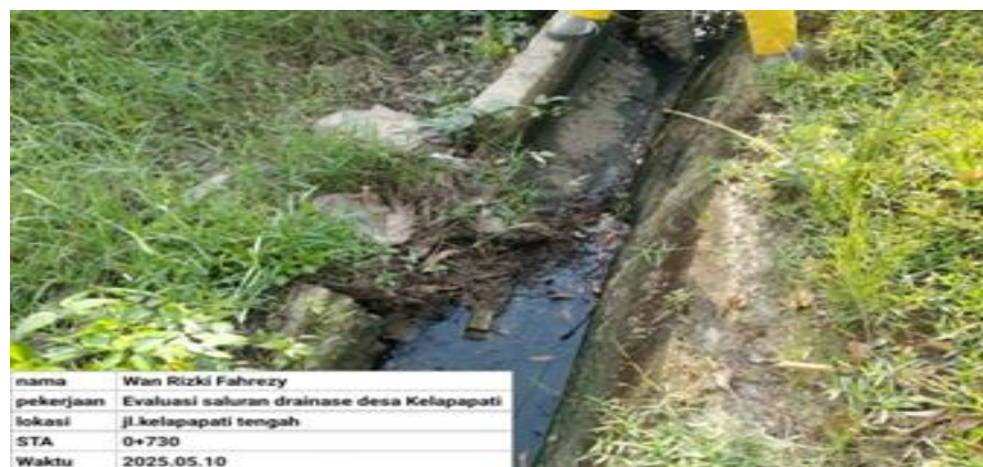
Gambar 4. 5 Kerusakan Drainase Sumber : Survey Lapangan (2025)
