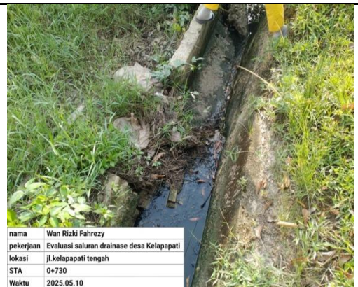
Kerusakan Drainase Di STA 0+750 Sebelah kiri
