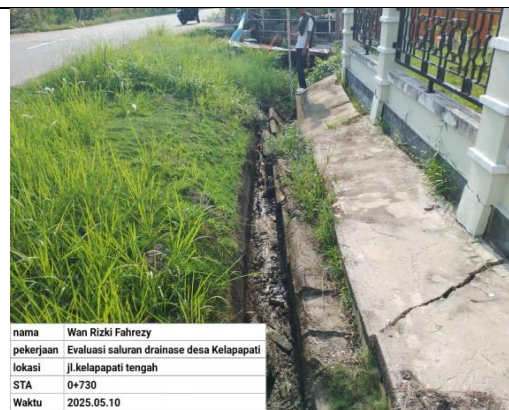
Kerusakan Drainase Di STA 0+750 Sebelah kanan
