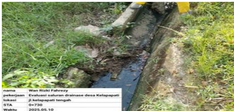
Gambar 4. 5 Kerusakan Drainase Sumber : Survey Lapangan (2025)
