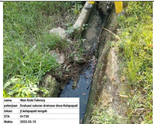
Kerusakan Drainase Di STA 0+750 Sebelah kiri
