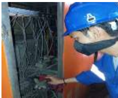
Gambar 3. 22 Perawatan panel (Sumber : Dokumentasi 2025)
