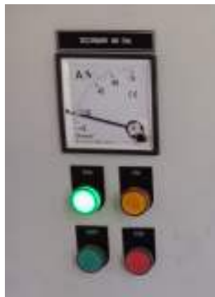
Gambar 4. 10 Pengukur ampere secondary air fan (Sumber : Dokumentasi 2025)
