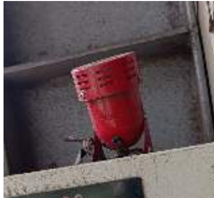
Gambar 4. 5 Alarm (Sumber : Dokumentasi 2025)
