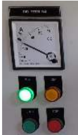
Gambar 4. 9 Pengukur ampere fuel feeder fan (Sumber : Dokumentasi 2025)
