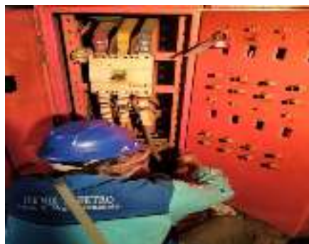
Gambar 3. 3 Perawatan panel (Sumber : Dokumentasi 2025)
