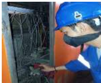
Gambar 3. 22 Perawatan panel (Sumber : Dokumentasi 2025)
