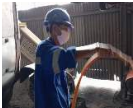
Gambar 3. 24 Perawatan elektro motor (Sumber : Dokumentasi 2025)
