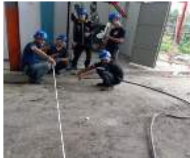
Gambar 3. 58 Pengukuran panjang kabel (Sumber : Dokumentasi 2025)
