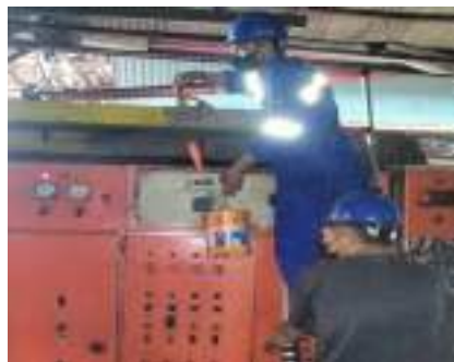
Gambar 3. 9 Perawatan panel (Sumber : Dokumentasi 2025)
