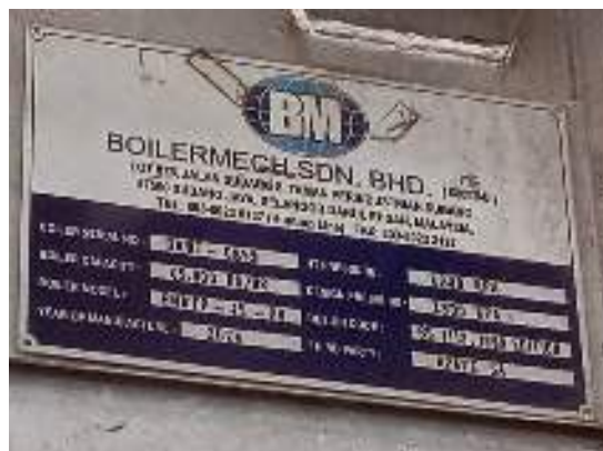
Gambar 4. 6 Nameplate (Sumber : Dokumentasi 2025)
