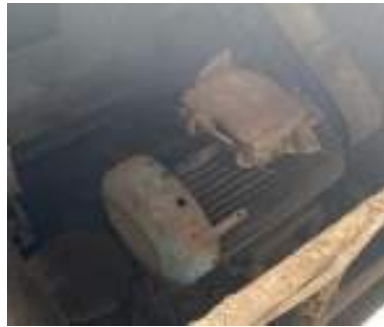
Gambar 3. 38 Perawatan elektro motor (Sumber : Dokumentasi 2025)
