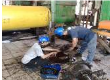
Gambar 3. 19 Service gearbox (Sumber : Dokumentasi 2025)
