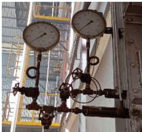
Gambar 4. 7 Manometer (Sumber : Dokumentasi 2025)
