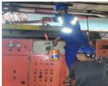
Gambar 3. 9 Perawatan panel (Sumber : Dokumentasi 2025)
