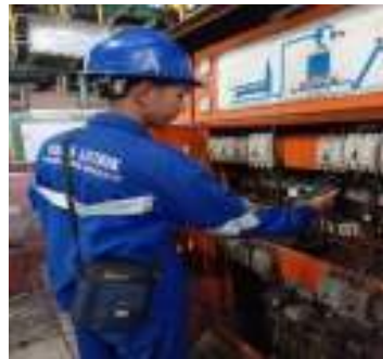
Gambar 3. 122 Mengukur ampere (Sumber : Dokumentasi 2025)
