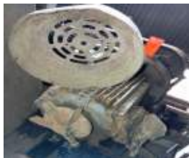
Gambar 3. 37 Perawatan elektro motor (Sumber : Dokumentasi 2025)
