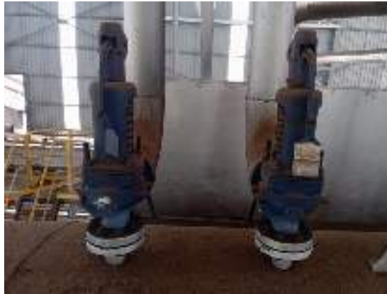
Gambar 4. 3 Safety valve (katub pengaman) (Sumber : Dokumentasi 2025)
