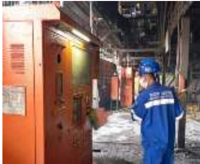
Gambar 3. 23 Perawatan panel (Sumber : Dokumentasi 2025)
