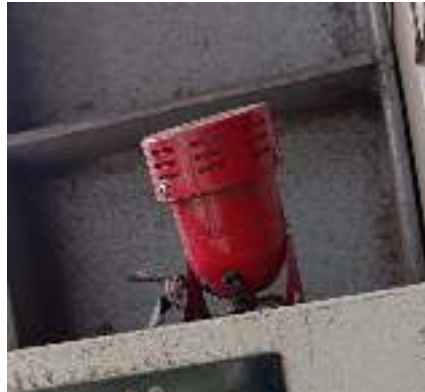
Gambar 4. 5 Alarm (Sumber : Dokumentasi 2025)
