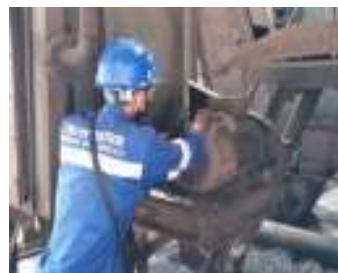
Gambar 3. 64 Cleaning elektro motor (Sumber : Dokumentasi 2025)
