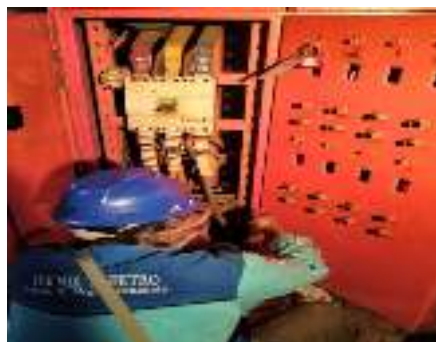
Gambar 3. 3 Perawatan panel (Sumber : Dokumentasi 2025)
