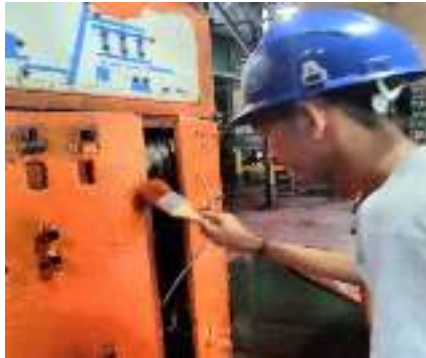
Gambar 3. 6 Perawatan panel (Sumber : Dokumentasi 2025)
