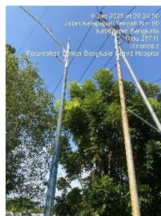
Gambar 3.1.1 Temuan inspeksi row pada kabel a3cs
