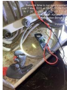
Gambar 3.1.5 Pengukuran beban trafo
