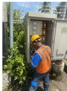
Gambar 3.1.2 Inspeksi pengukuran tegangan siang pada trafo
