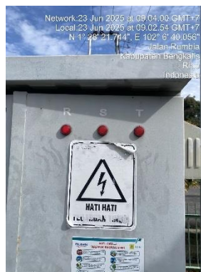
Gambar 3.3.9 PHB-TR (Panel Hubung Bagi-Tegangan Rendah)
