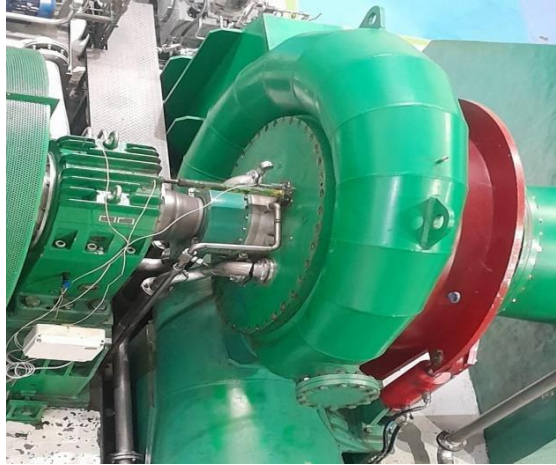
Gambar 4. 9 Rumah Turbin ( Casing/Spiral case ) Sumber: Dokumen Pribadi.
