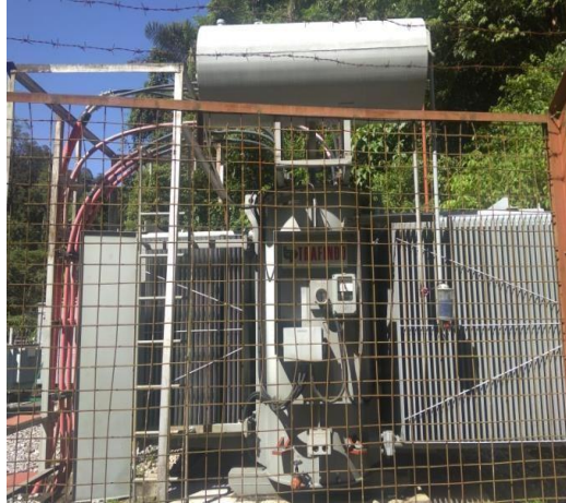
Gambar 4. 6 Transformator Tenaga 20kV Sumber: Dokumen Pribadi
