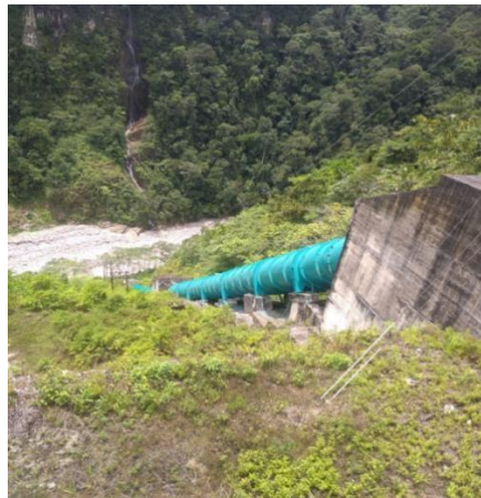
Gambar 4. 3 Pipa Pesat (Penstock) Sumber: Dokumen Pribadi
