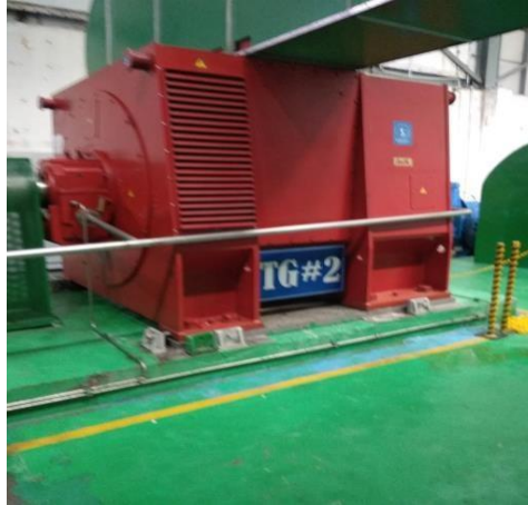
Gambar 4. 4 Generator Sumber: Dokumen Pribadi
