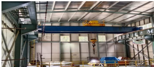
Gambar 3. 1 Hoist Crane (Overhead Crane)
