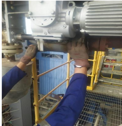
Gambar 4. 19 Pengecekan Oli Gearbox Operasi (Sumber: Dokumentasi Pribadi)
