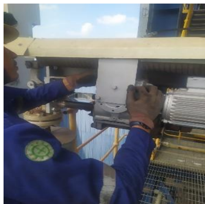
Gambar 4. 16 Pemeriksaan Grease Gearbox (Sumber: Dokumentasi Pribadi)
