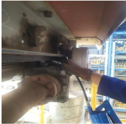
Gambar 4. 15 Pelumasan pada Gear Rack (Sumber: Dokumentasi Pribadi)
