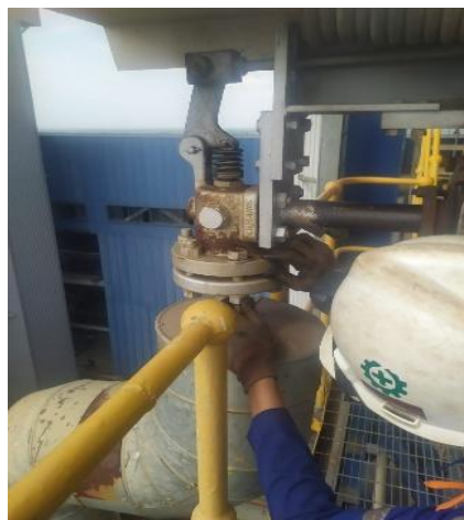
Gambar 4. 18 Pemeriksaan Pada Flange (Sumber: Dokumentasi Pribadi)
