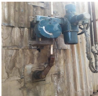
Gambar 3. 5 PM Diarea Flue Gas Dumper (Sumber: Dokumentasi Pribadi)
