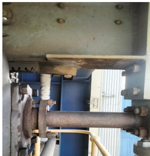
Gambar 4.9 Seal Gland Packing (Sumber: Dokumentasi Pribadi)
