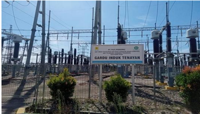
Gambar 2.2 Gardu Induk PLTU Tenayan (Sumber: Dokumentasi Pribadi)
