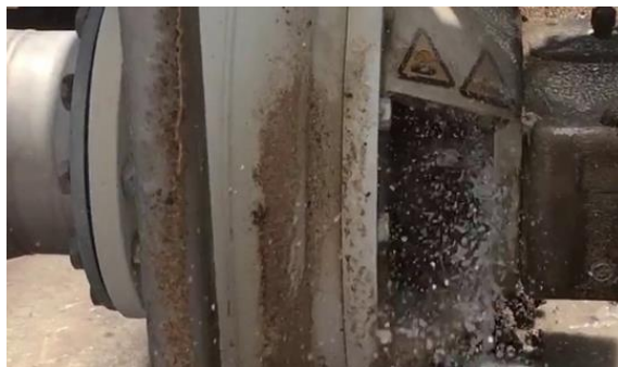
Gambar 4.3. 2 kerusakan pada seal
