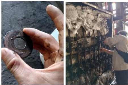
Gambar 3. 22 valve gland turbin 3 (Sumber Dokumentasi: PT.Sari Dumai Sejati)
