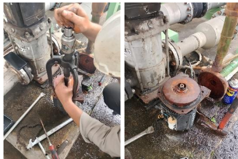
Gambar 3. 24 Impeler pompa (Sumber Dokumentasi: PT. Power Plant)
