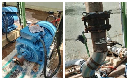
Gambar 3. 13 Motor pompa BWRO (Sumber Dokumentasi: PT. Power Plant)
