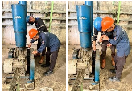
Gambar 3. 10 air blower K002 (Sumber Dokumentasi: PT. Power Plant)
