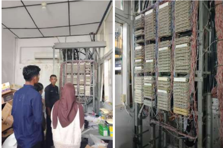
Gambar 3. 1 Instalasi Jaringan Intranet Pada Perangkat Main Distribution Frame
