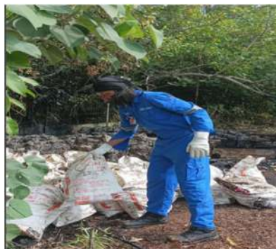
Gambar 3.6 pembersihan sisa kebocoran pipa minyak area marine (Sumber: Dokumentasi Lapangan, 2024)
