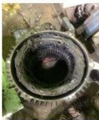
Gambar 3.36 Pembogkran Emot Yang Kebakar (Sumber: Dokumentasi di PTPN IV Sei Buatan,2025)
