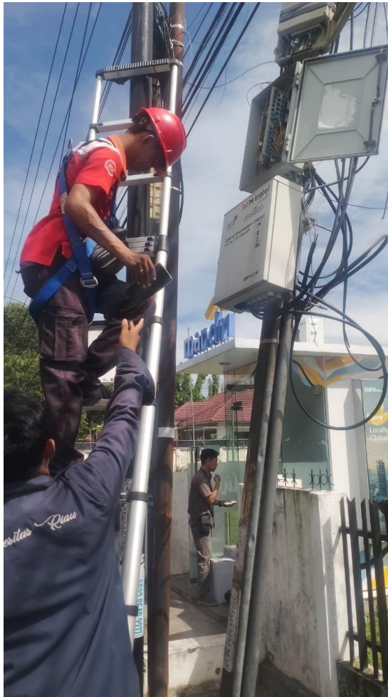
Gambar 3.1 Eviden Pemndampingan Instalasi Jaringan WIFI
