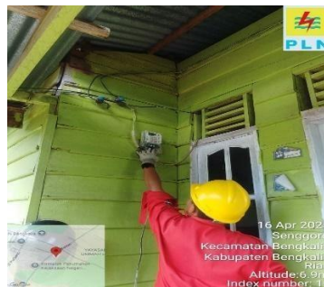
Gambar 3. 27 pemeriksaan Kwh meter pelanggan. (Sumber: Dokumentasi, 2025)
