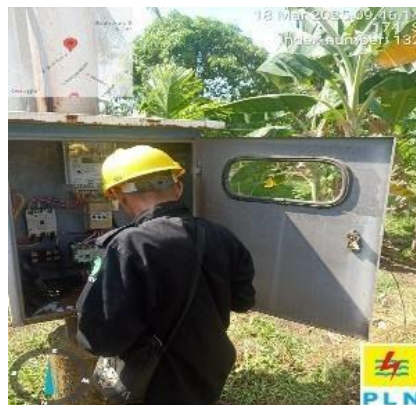
Gambar 3. 20 pemeriksaan Kwh meter pelanggan (Sumber: Dokumentasi, 2025)
