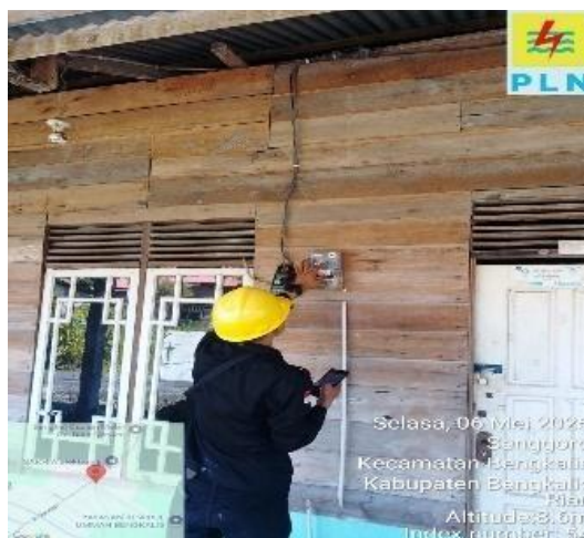
Gambar 3. 32 pemeriksaan Kwh meter pelanggan. (Sumber: Dokumentasi, 2025)
