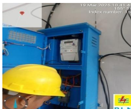
Gambar 3. 21 pemeriksaan Kwh meter pelanggan. (Sumber: Dokumentasi, 2025)
