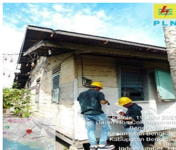
Gambar 3. 51 pemeriksaan Kwh meter pelanggan. (Sumber: Dokumentasi, 2025)
