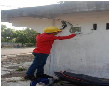
Gambar 3. 4 pengecekan Kwh meter pelanggan (Sumber: Dokumentasi, 2025)
