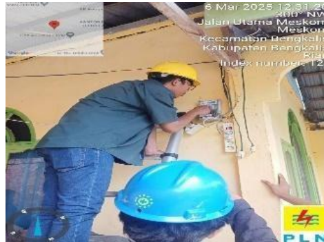
Gambar 3. 15 pemeriksaan Kwh meter pelanggan. (Sumber:Dokumentasi,2025)
