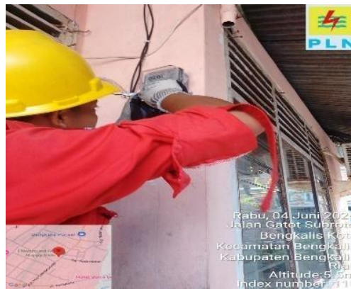
Gambar 3. 44 pemeriksaan Kwh meter pelanggan. (Sumber: Dokumentasi, 2025)
