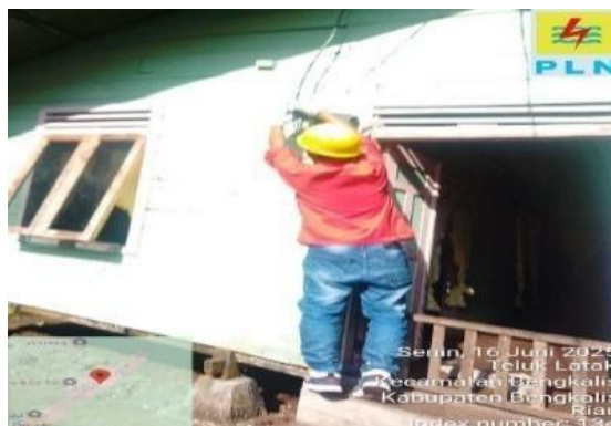
Gambar 3. 49 pemeriksaan Kwh meter pelanggan. (Sumber: Dokumentasi, 2025)
