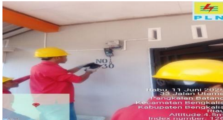
Gambar 3. 46 pemeriksaan Kwh meter pelanggan. (Sumber: Dokumentasi, 2025)
