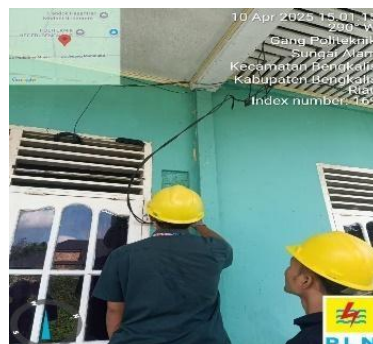
Gambar 3. 25 pemeriksaan Kwh meter pelanggan. (Sumber: Dokumentasi,2025)
