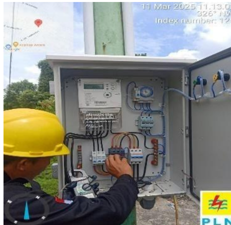
Gambar 3. 16 pemeriksaan Kwh meter pelanggan. (Sumber: Dokumentasi, 2025)
