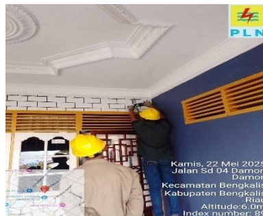
Gambar 3. 38 pemeriksaan Kwh meter pelanggan. (Sumber: Dokumentasi, 2025)
