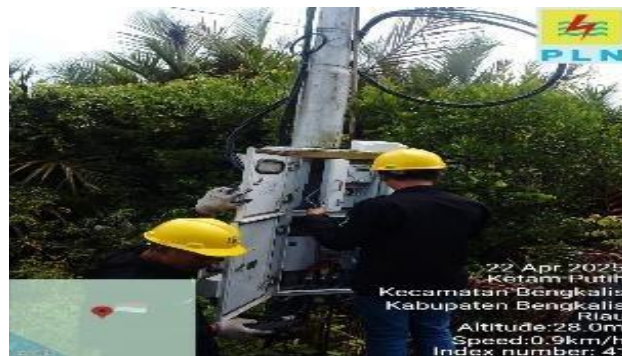
Gambar 3. 29 pemeriksaan Kwh meter pelanggan. (Sumber: Dokumentasi, 2025)
