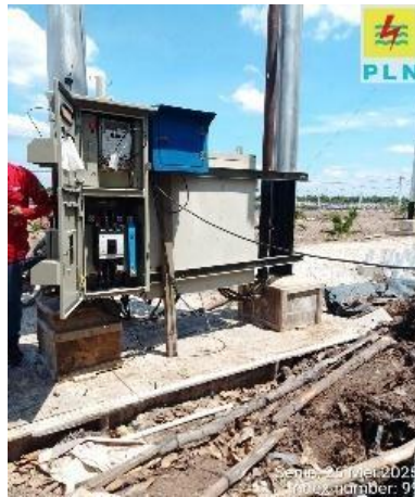
Gambar 3. 40 pemeriksaan Kwh meter pelanggan. (Sumber: Dokumentasi, 2025)
