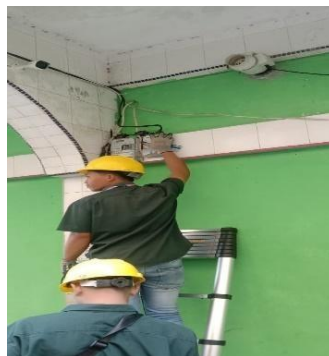
Gambar 3. 5 pengecekan Kwh meter pelanggan. (Sumber: Dokumentasi, 2025)
