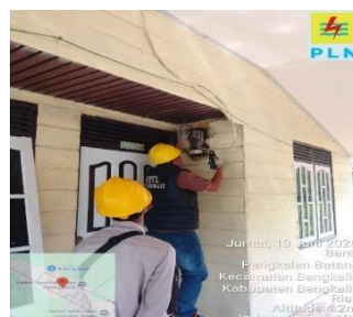
Gambar 3. 48 pemeriksaan Kwh meter pelanggan. (Sumber: Dokumentasi, 2025)
