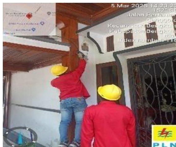
Gambar 3. 14 pemeriksaan Kwh meter pelanggan. (Sumber: Dokumentasi,2025)
