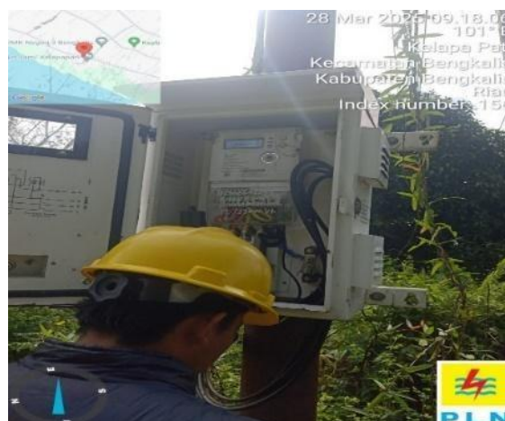
Gambar 3. 23 pemeriksaan Kwh meter pelanggan. (Sumber: Dokumentasi, 2025)
