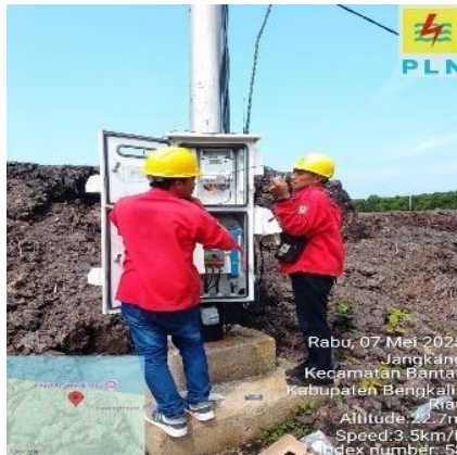
Gambar 3. 33 pemeriksaan Kwh meter pelanggan. (Sumber: Dokumentasi, 2025)
