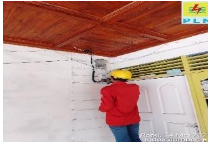
Gambar 3. 34 pemeriksaan Kwh meter pelanggan. (Sumber: Dokumentasi, 2025)
