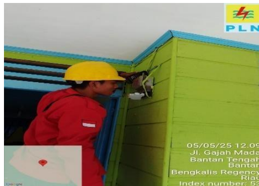
Gambar 3. 31 pemeriksaan Kwh meter pelanggan. (Sumber: Dokumentasi, 2025)
