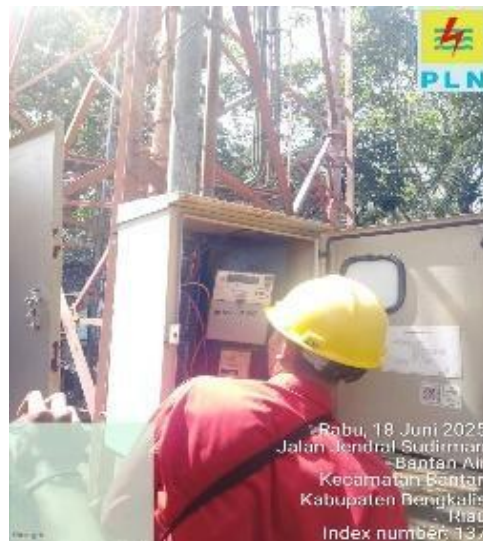
Gambar 3. 50 pemeriksaan Kwh meter pelanggan. (Sumber: Dokumentasi, 2025)
