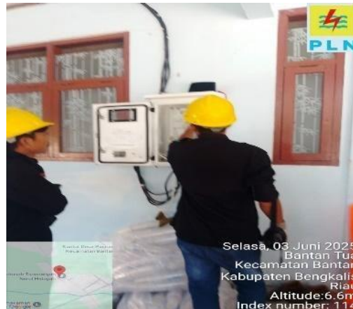
Gambar 3. 43 pemeriksaan Kwh meter pelanggan. (Sumber: Dokumentasi, 2025)
