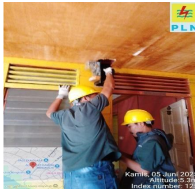
Gambar 3. 45 pemeriksaan Kwh meter pelanggan. (Sumber: Dokumentasi,2025)
