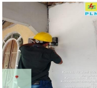
Gambar 3. 47 pemeriksaan Kwh meter pelanggan. (Sumber: Dokumentasi, 2025)
