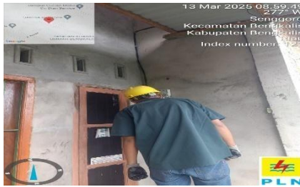
Gambar 3. 18 pemeriksaan Kwh meter pelanggan. (Sumber: Dokumentasi, 2025)
