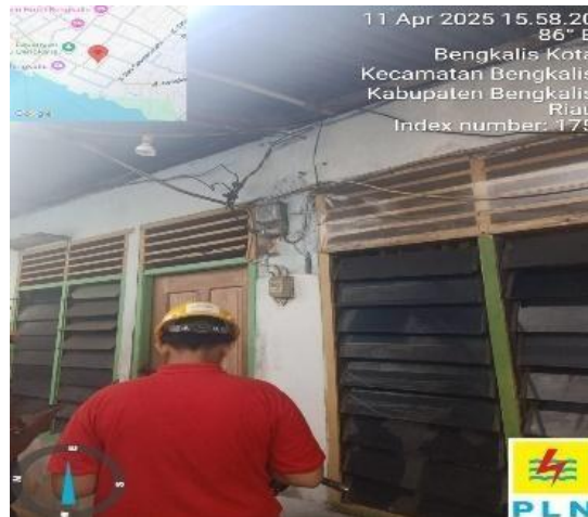
Gambar 3. 26 pemeriksaan Kwh meter pelanggan. (Sumber: Dokumentasi,2025)
