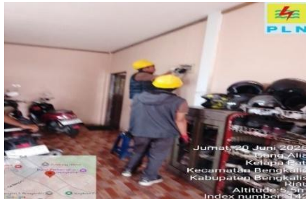
Gambar 3. 52 pemeriksaan Kwh meter pelanggan. (Sumber: Dokumentasi, 2025)
