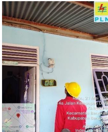
Gambar 3. 37 pemeriksaan Kwh meter pelanggan. (Sumber: Dokumentasi, 2025)
