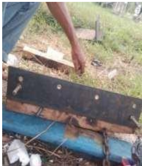
1.8 Pemotongan Baut Kedudukan Pompa Siput
