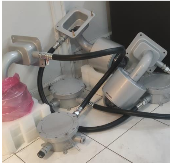
Gambar 3. 4 Hasil Pemasangan CCTV
