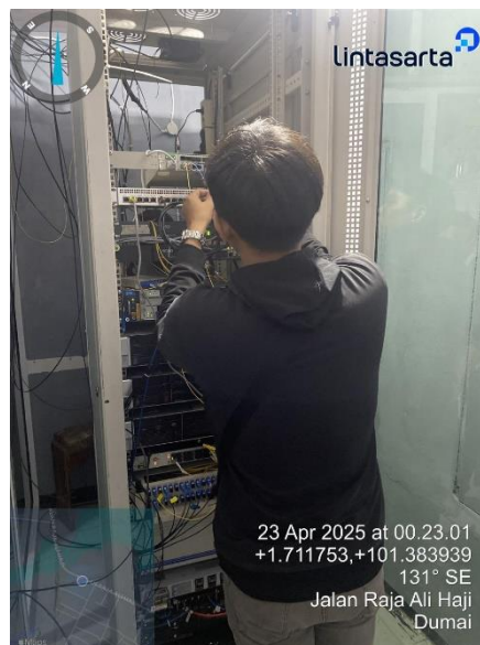
Gambar 3. 21 Pemasangan Perangkat switc di pelanggan SAS Dumai
