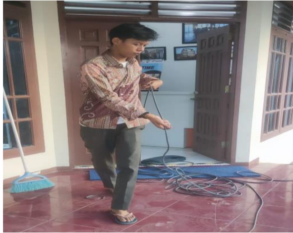
Gambar 4. 5 Routing Kabel dari Antena ke Router
