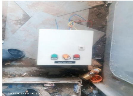
Gambar 3. 58 Panel listrik di wheel house
