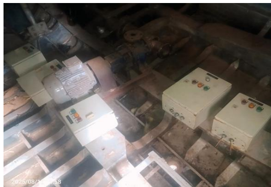
Gambar 3. 57 Panel eletrik pada ruang mesin
