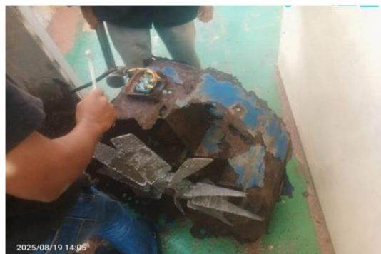
Gambar 3. 62 Blower yang sudah terbuka
