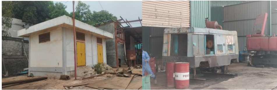
Gambar 2.7 Generator set dan Listrik PL
