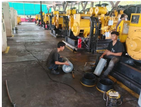
Gambar 3. 29 Pembersihan filter udara pada unit genset
