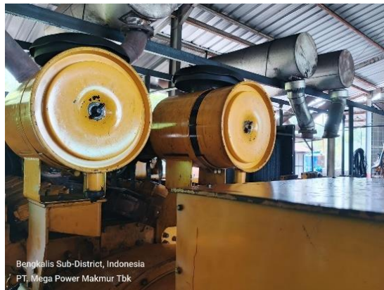
Gambar3. 31 Penggantian filter udara pada unit genset.
