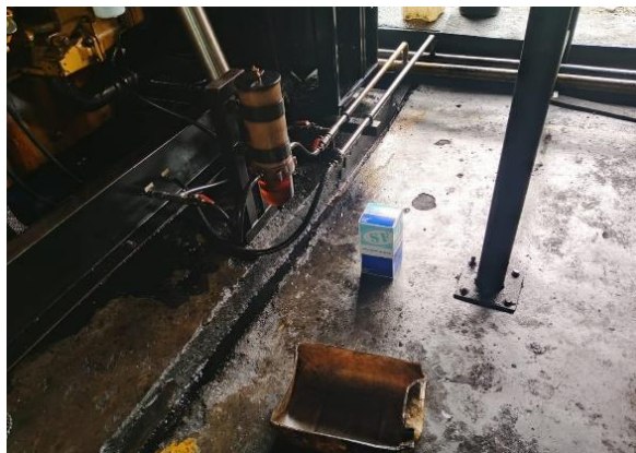
Gambar 3. 35 Pelaksanaan servis bulanan pada beberapa unit genset.
