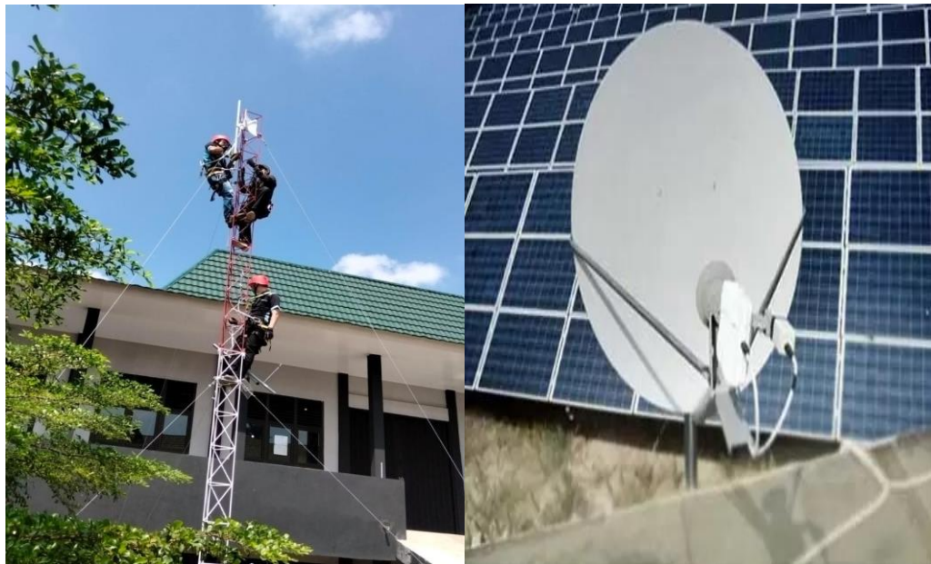
Gambar 3.1 Hasil Instalasi Jaringan Point to Point
