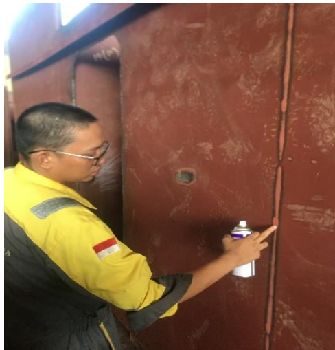
Gambar 3. 29 Penetrant Test Sumber: Penulis
