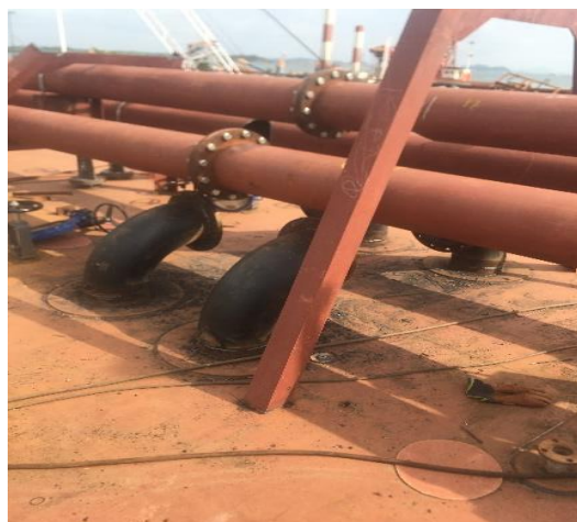
Gambar 3. 22 Pipa Pada Deck Oil Barge Sumber: Penulis
