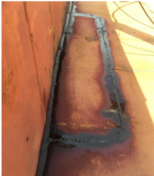
Gambar 3. 62 Penetrant Test Sumber : Penulis
