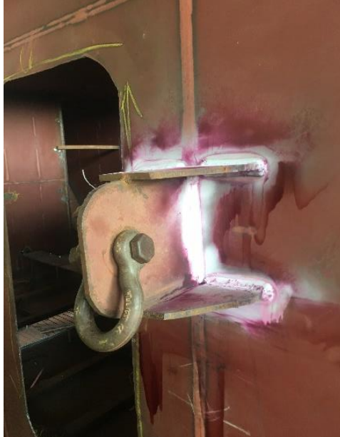
Gambar 3. 41 Penetrant Test Sumber: Penulis
