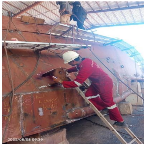
Gambar 3. 32 Penetrant Test Sumber: Penulis
