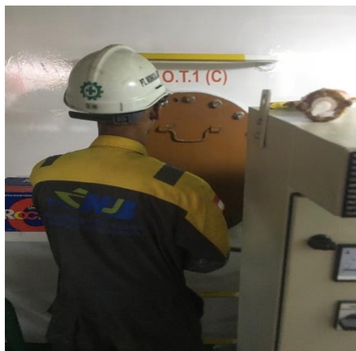
Gambar 3. 30 Pintu Manhole Sumber: Penulis
