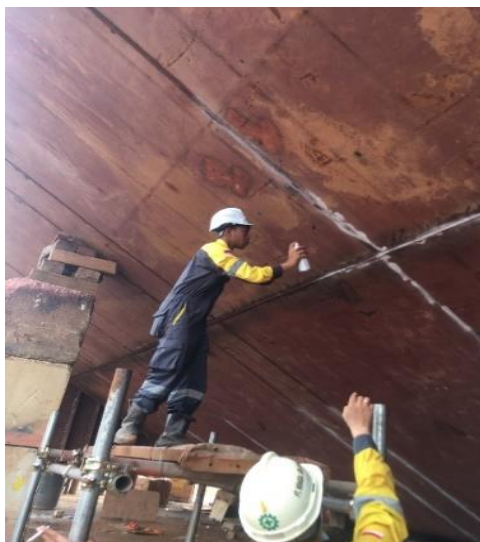
Gambar 3. 50 Penetrant Test Sumber : Penulis
