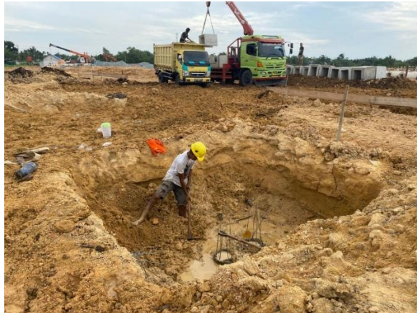
Gambar 3. 100 Pembobokan atau pemotongan tiang pancang yang berlebih
